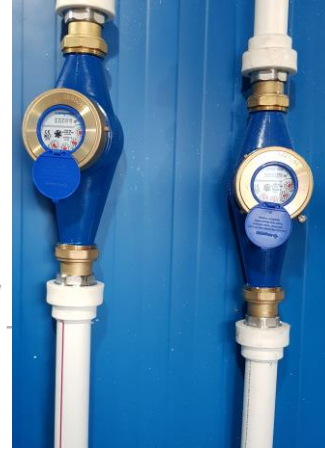
Kirli su Giriş ve Rehabilitasyon su Çıkış Sayaçları
