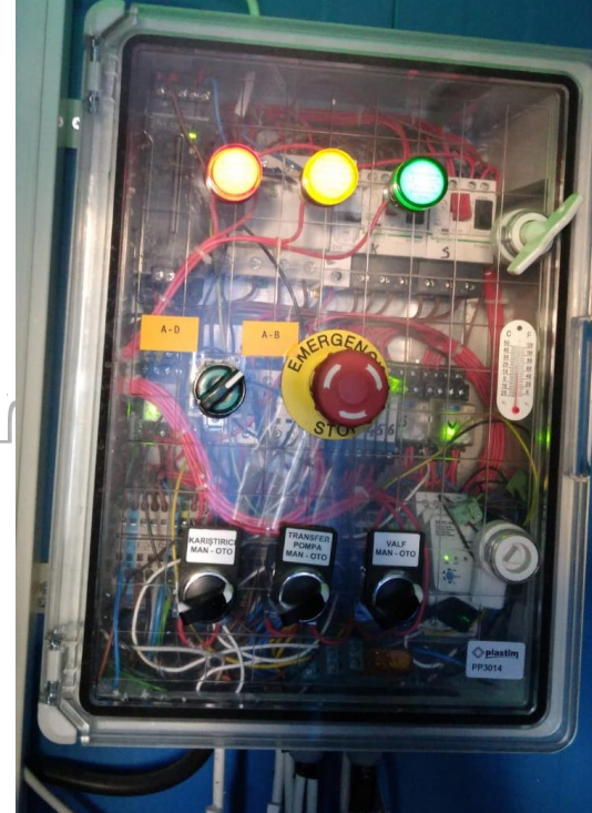
AyDo™ Elektro Mekanik Panosu-V1
